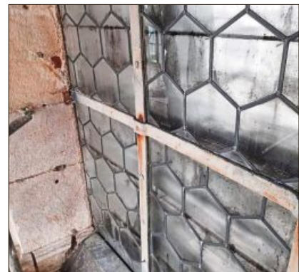
Rost an der Fensterkonstruktion mit Bleiverglasung.
