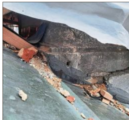
Fehlende Mauerstücke, bröselnde Steine.
