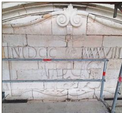
Schadensbilder der Fassade: Inschrift mit Entstehungsdatum: 1738.
